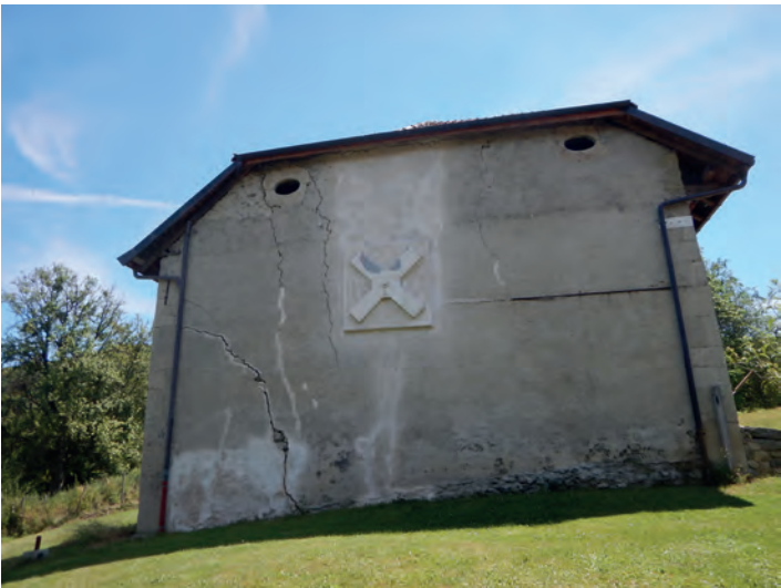
Image 6. Désordres à l'extérieur des bâtiments
